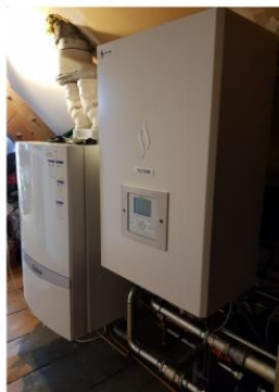
Hybride warmtepomp. Links de cv-ketel, rechts de warmtepomp.
