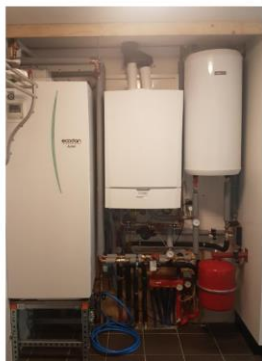
Hybride warmtepomp. Links de warmtepomp, in het midden een cv-ketel, rechts een boilervat.
