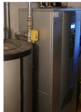
Warmtepomp zonder aardgas. Rechts de warmtepomp, links een boilervat.
